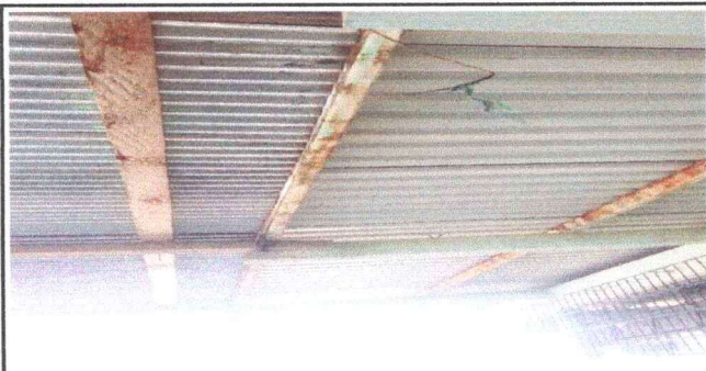
Foto 1: Cubierta de lámina con perforacion y en mal estado del módulo 1.
