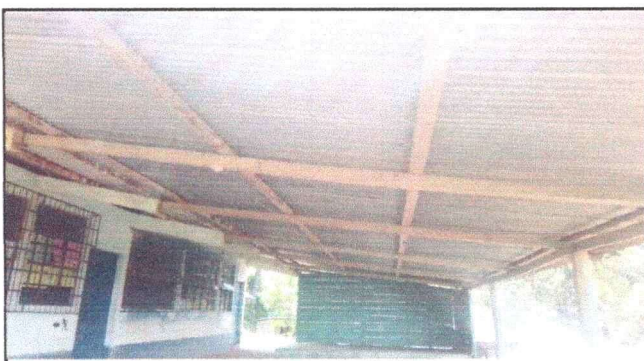
Foto 3: Estructura del techo de madera en mal estado, del módulo 1 que necesita ser cambiado.
