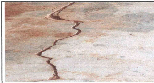
Foto 5: Imagen de piso de salon estudiantil en mal estado que necesita ser remozado con urgencia.
