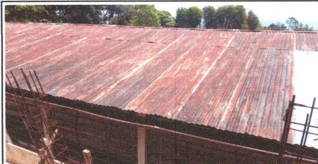
Foto 2: Vista superior de cubierta de lamina oxidada y en mal estado del modulo 2.
