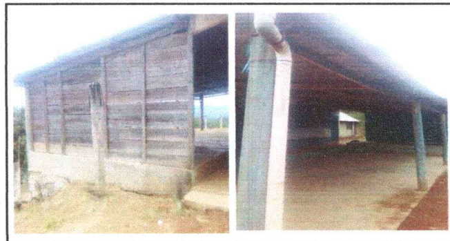
Foto 6: Vista lateral de salón estudiantil en mal estado, que necesita rehabilitación de paredes.
