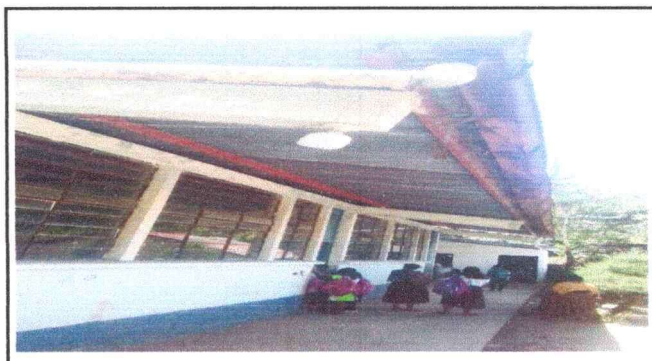
Foto 4: Estructura de techo de dos aulas en mal estado del modulo 2.
